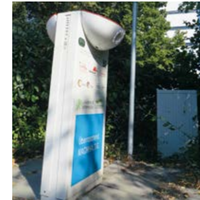
Die Elektrotankstelle auf dem Besucherparkplatz des Landratsamts Göppingen.
