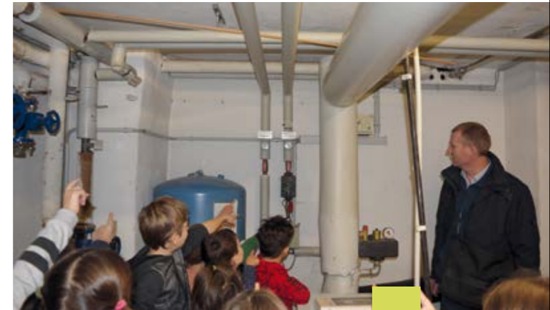
Energieberater G. Sattler weist auf energetische Schwachstellen im Heizungskeller hin
